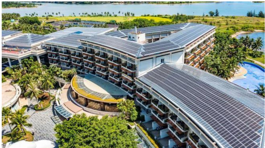
会议中心酒店屋面太阳能光伏板
